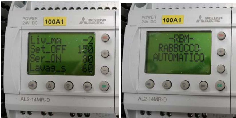
Schermata PLC interno al quadro del RA-IN Schermata parametri di regolazione soglie start&stop rabbocco
