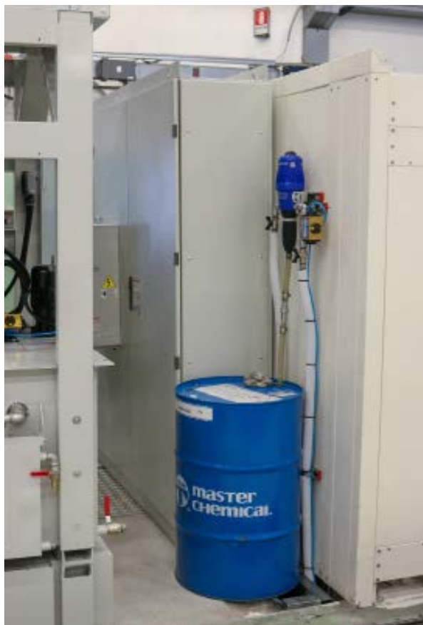
Rabbocco automatico gestito da impianto RBM su singola macchina
